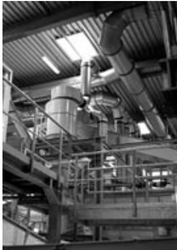
Umhauste Müllaufbereitung, staubfrei und geruchsarm.
