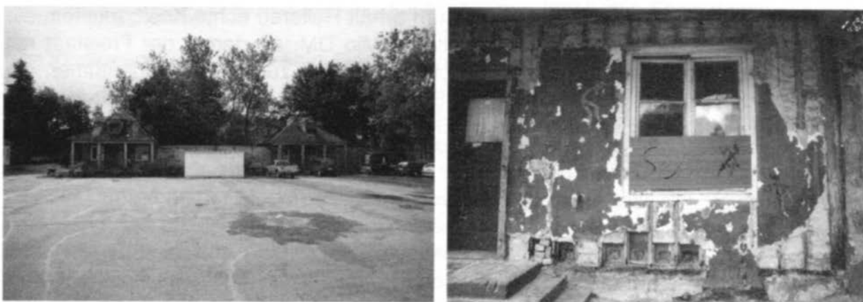
Die beiden westlichen Pensionshäuser vor der Sanierung 1999, todkrank
